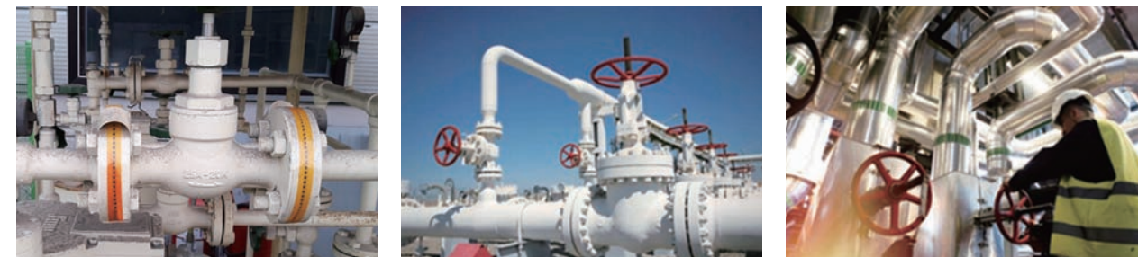
누출감지 테이프 적용 사례 Case of chemical detection tape application
